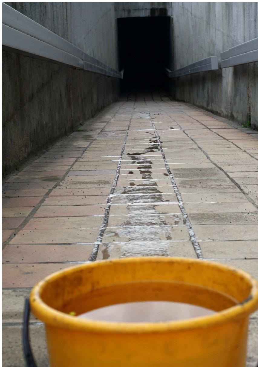
10. Podchody Vltavská, Praha, 2013, foto – prasklý kbelík určuje směr divákům (foto Jas)
