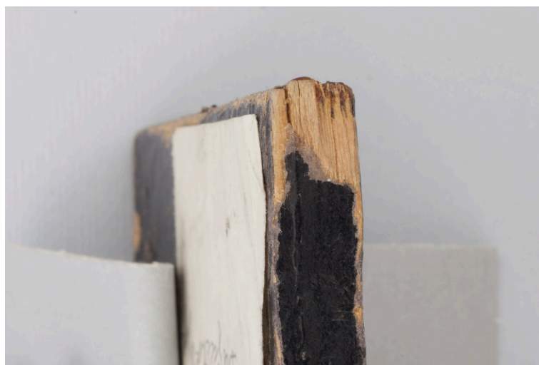
obr. 52 odštípnutí fragmentu dřevěné konstrukce
